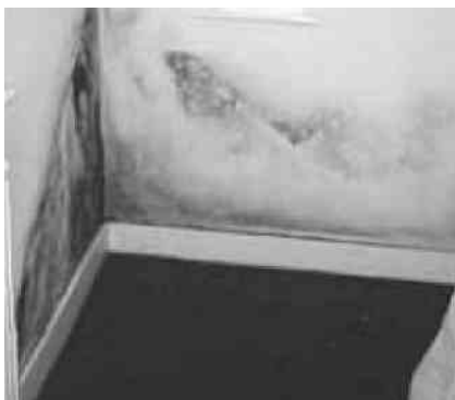
Paredes com crescimento de mofo preto
